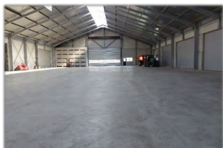
Un des Halls d'entrée pour accéder aux cellules de stockage pomme de terre de part et d'autre et permettant le chargement, le tri ou l'emballage
