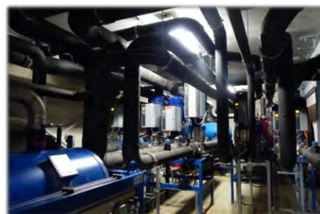
La salle des machines pour la compression de l'ammoniac
